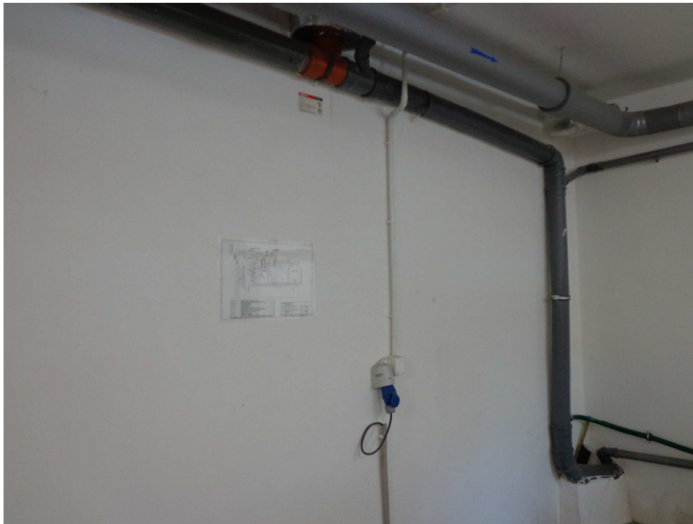
Fot. Istniejąca automatyka która należy dostosować do pracy wraz z pompą ciepłą.
