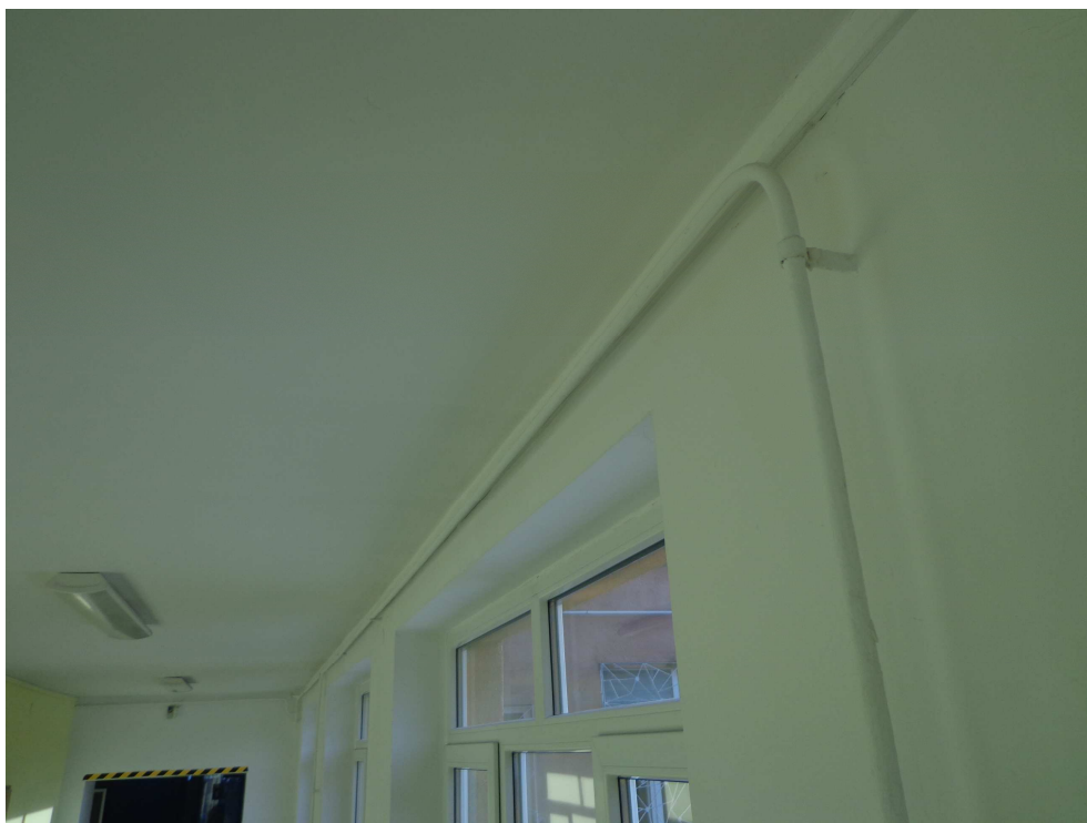
Fot. Istniejąca instalacja elektryczna i CO do przebudowy.
