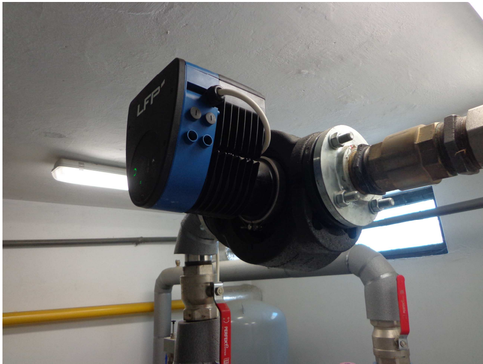
Fot. Istniejąca automatyka która należy dostosować do pracy wraz z pompą ciepła.
