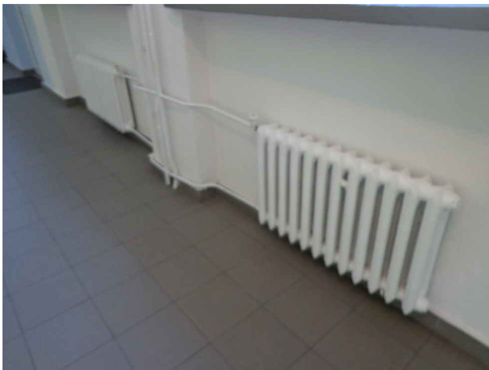
Fot. Istniejąca instalacja CO do przebudowy.
