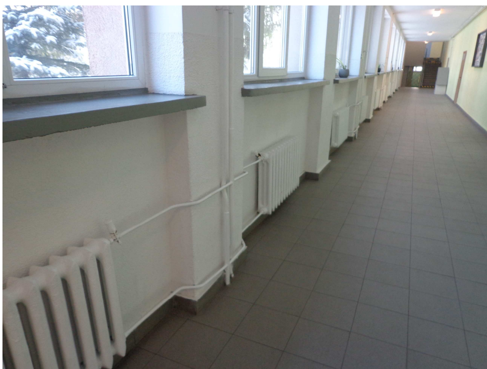
Fot. Istniejąca instalacja CO do przebudowy.
