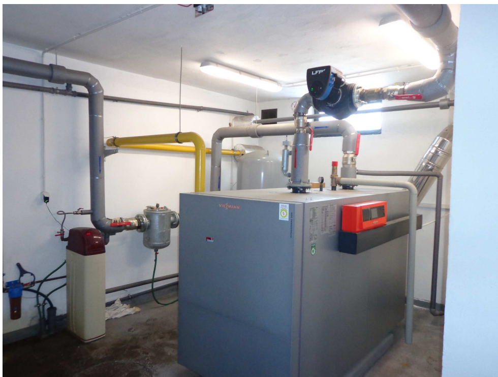
Fot. Istniejący kocioł na gaz wraz z automatyką którą należy dostosować do pracy wraz z pompą ciepła.
