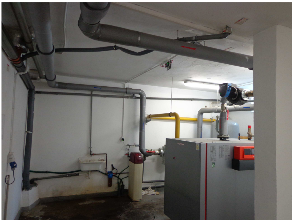
Fot. Istniejąca automatyka która należy dostosować do pracy wraz z pompą ciepła.
