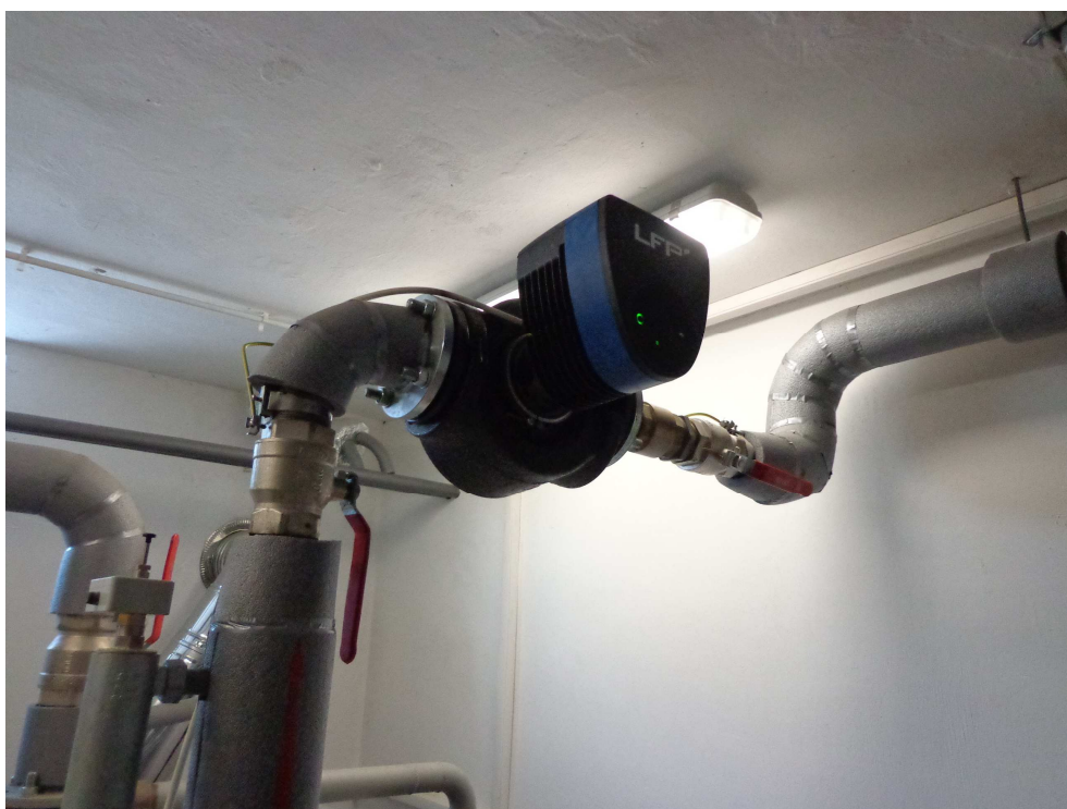
Fot. Istniejąca automatyka którą należy dostosować do pracy wraz z pompą ciepła.
