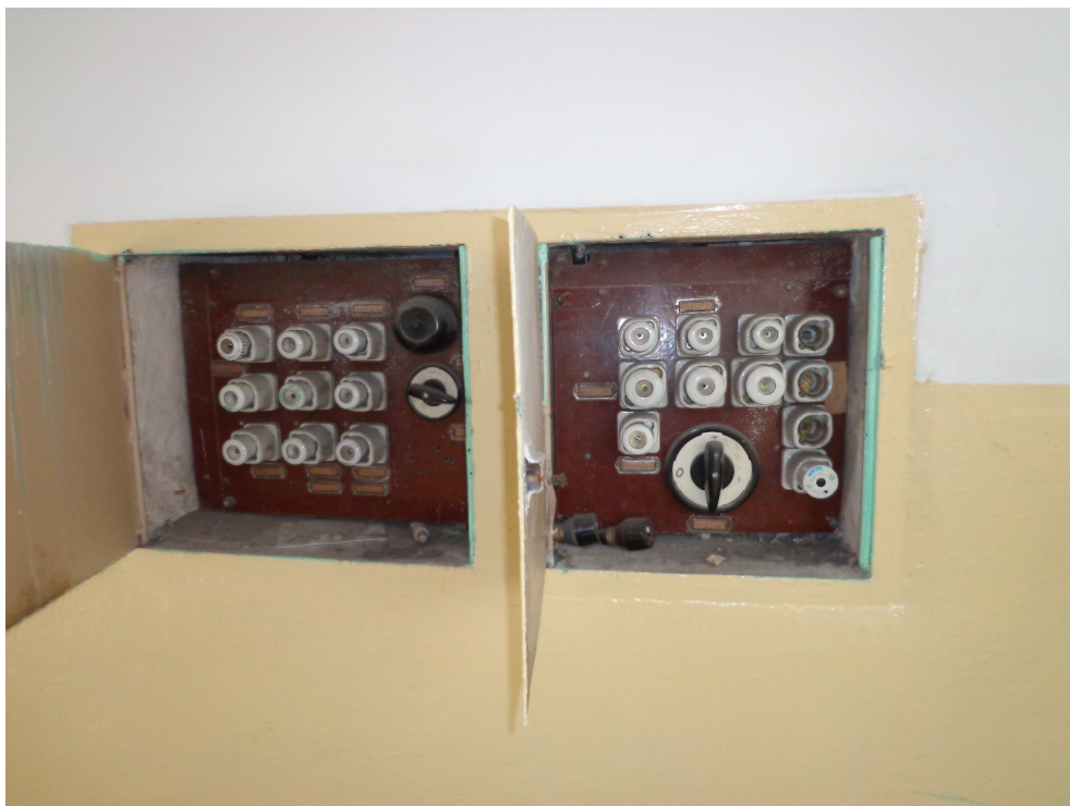
Fot. Przykład istniejącej rozdzielni do przebudowy.
