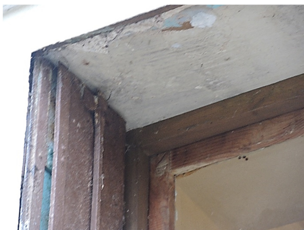
Fot. 13 Przykładowe okno w el. frontowej (południowej), stalowa ościeżnica do usunięcia
