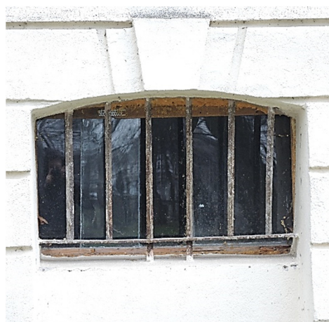
Fot. 14 Przykładowe okno w piwnicy, kraty do usunięcia
