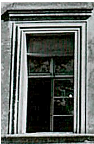
Fot. 16 Widok stolarki okiennej, w poziomie parteru [źródło: zielona karta obiektu zabytkowego]
